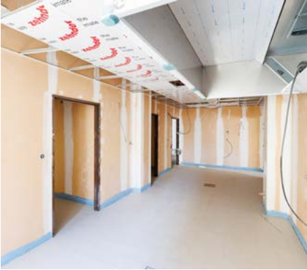
Les éléments du réseau de ventilation de la cuisine sont visibles en plafond (mai 2025).
